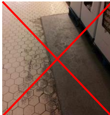
revêtement de sol inadapté
