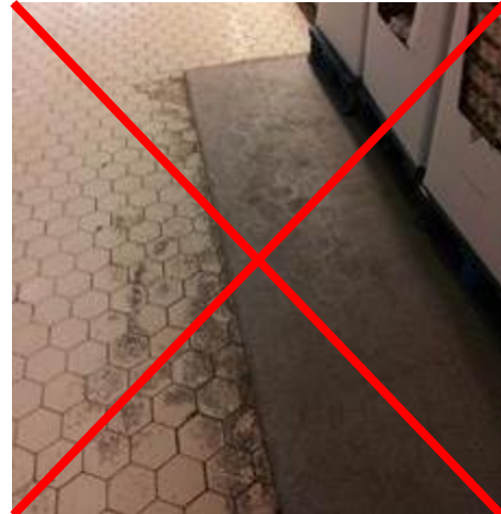
revêtement de sol inadapté
